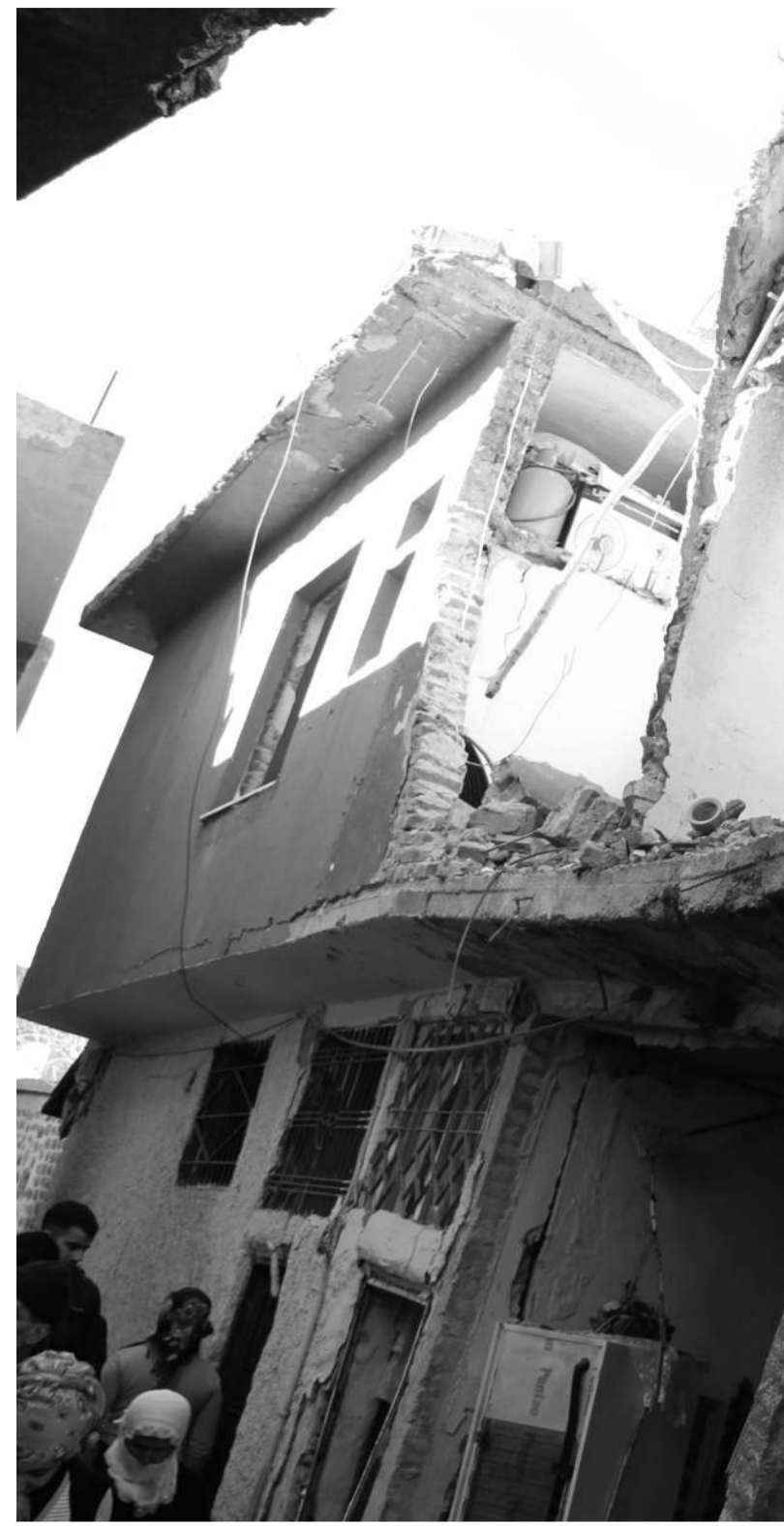
Dans la ville de Sur, zone historique de Diyarbakir, 1100 bâtiments sont en ruine
